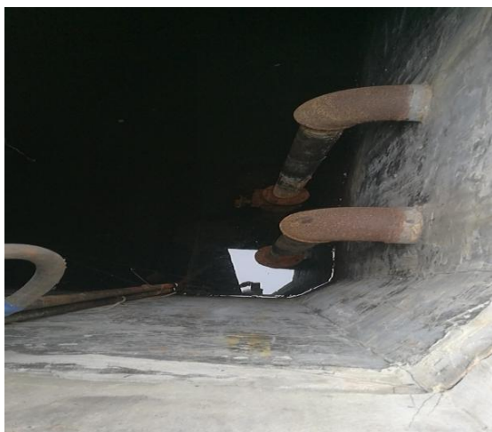
事故水提升泵及提升管
