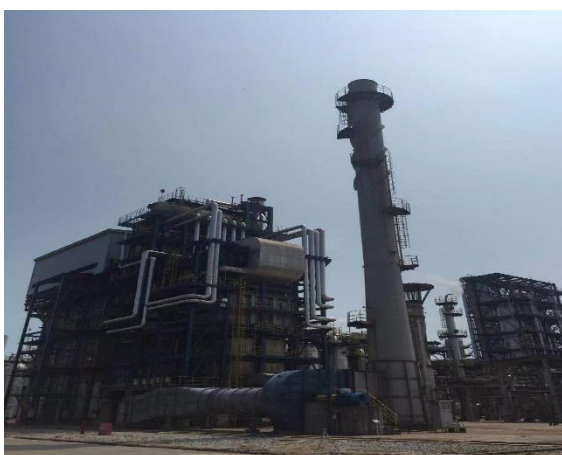
制氢装置转化炉
