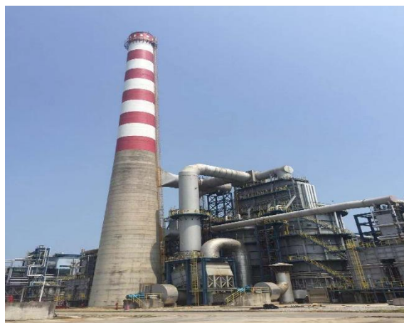
加氢裂化装置加热炉
