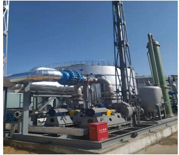
污水处理场脱臭设施
