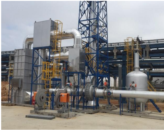
“三苯”储罐废气设施
