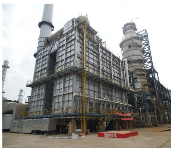
凝析油分离装置分馏塔重沸炉
