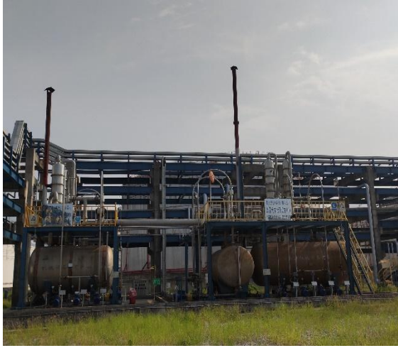
罐区脱臭设施
