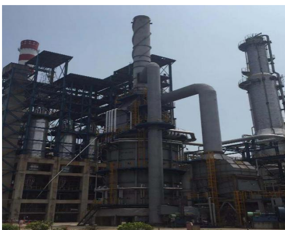
催化重整装置稳定塔重沸炉
