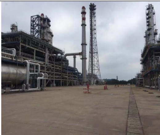
减压蒸馏装置加热炉
